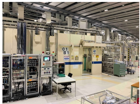
写真 1 BL01B1 外観。左側手前には計測機器類が並ぶ。中央が EH の出入口扉であり、ビームライン下流側 (右奥) にガスボンベキャビネットおよび排ガス処理装置が設置されている。
