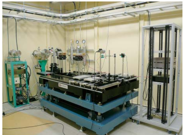
写真3 実験ハッチ内に設置されたミラー用定盤とXAFS測定用定盤
