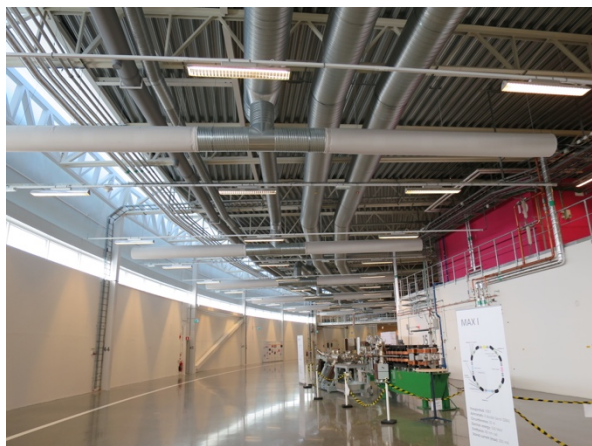
図3 MAX IV 実験ホールの研磨されたコンクリート床と天井の布製空調吹き出しダクト。
