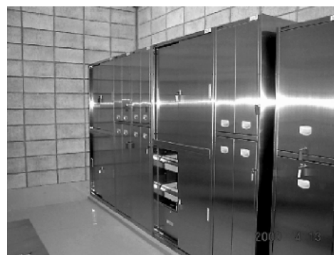
少量危険物貯蔵庫内部（保管室4）
