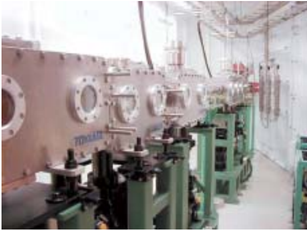
Fig. 9 ミラー用真空チェンバーの設置状況
