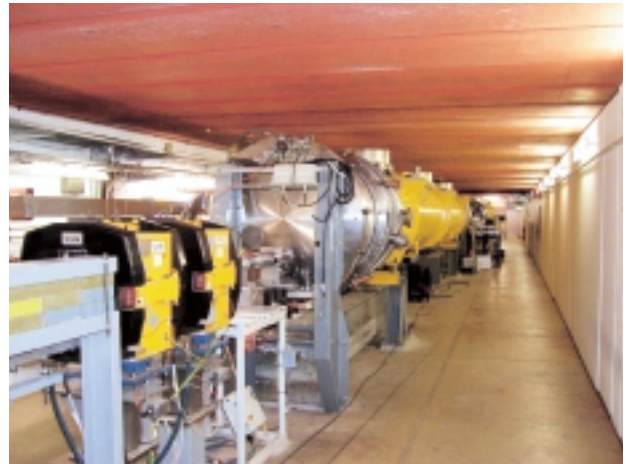
図3 DESY TTF (TESLA TEST STAND) の超伝導線型加速器。
