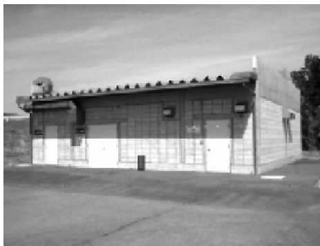
少量危険物貯蔵庫外観
