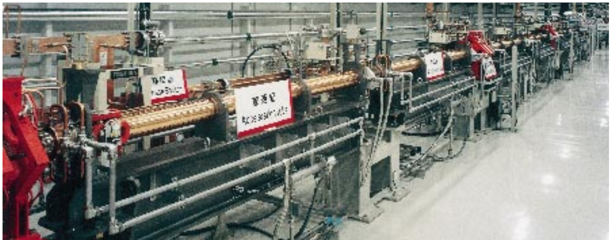
線型加速器 加速管室内部 (H8.8)
